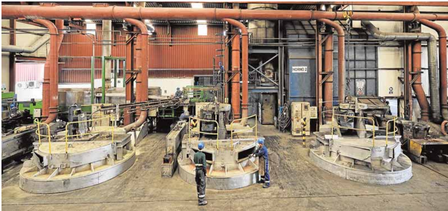
Interior de las instalaciones de fundición de plomo de Azor Ambiental, en el polígono molinense de La Polvorista. :: A. A.
